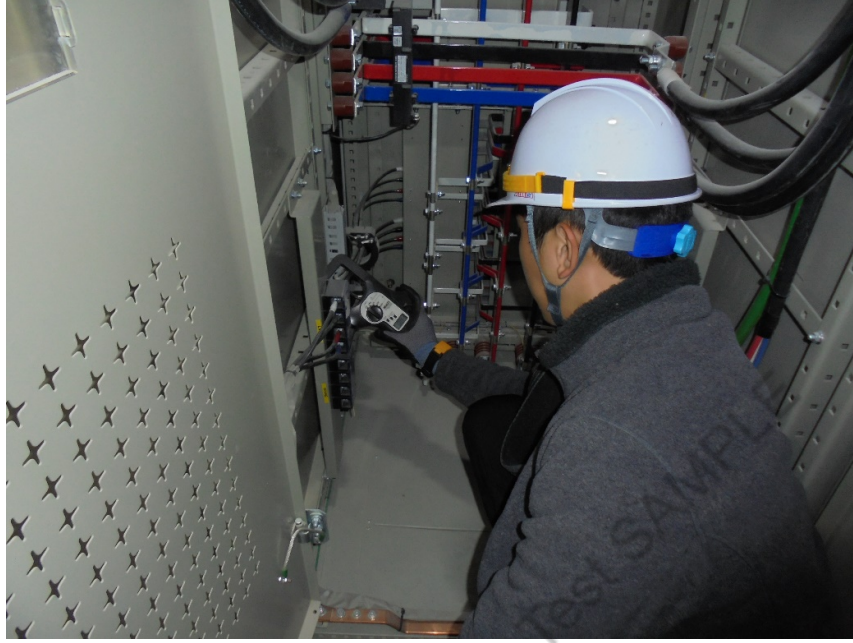
저압배전반 누설전류 측정
