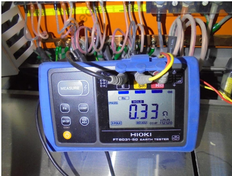
위험물 취급소 MCC PANEL
